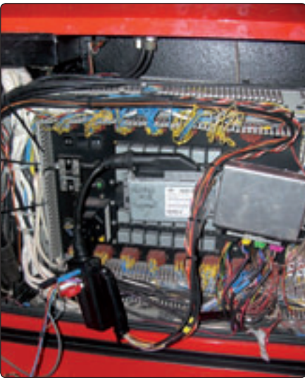
A beépített elektronika és a hozzá csatlakoztatott diagnosztikai kábel
